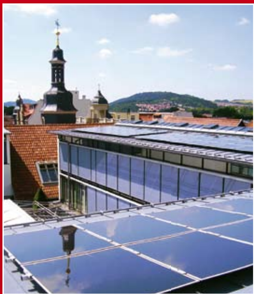
Photovoltaik-Anlage auf der Hauptstelle der Wartburg-Sparkasse in Eisenach
