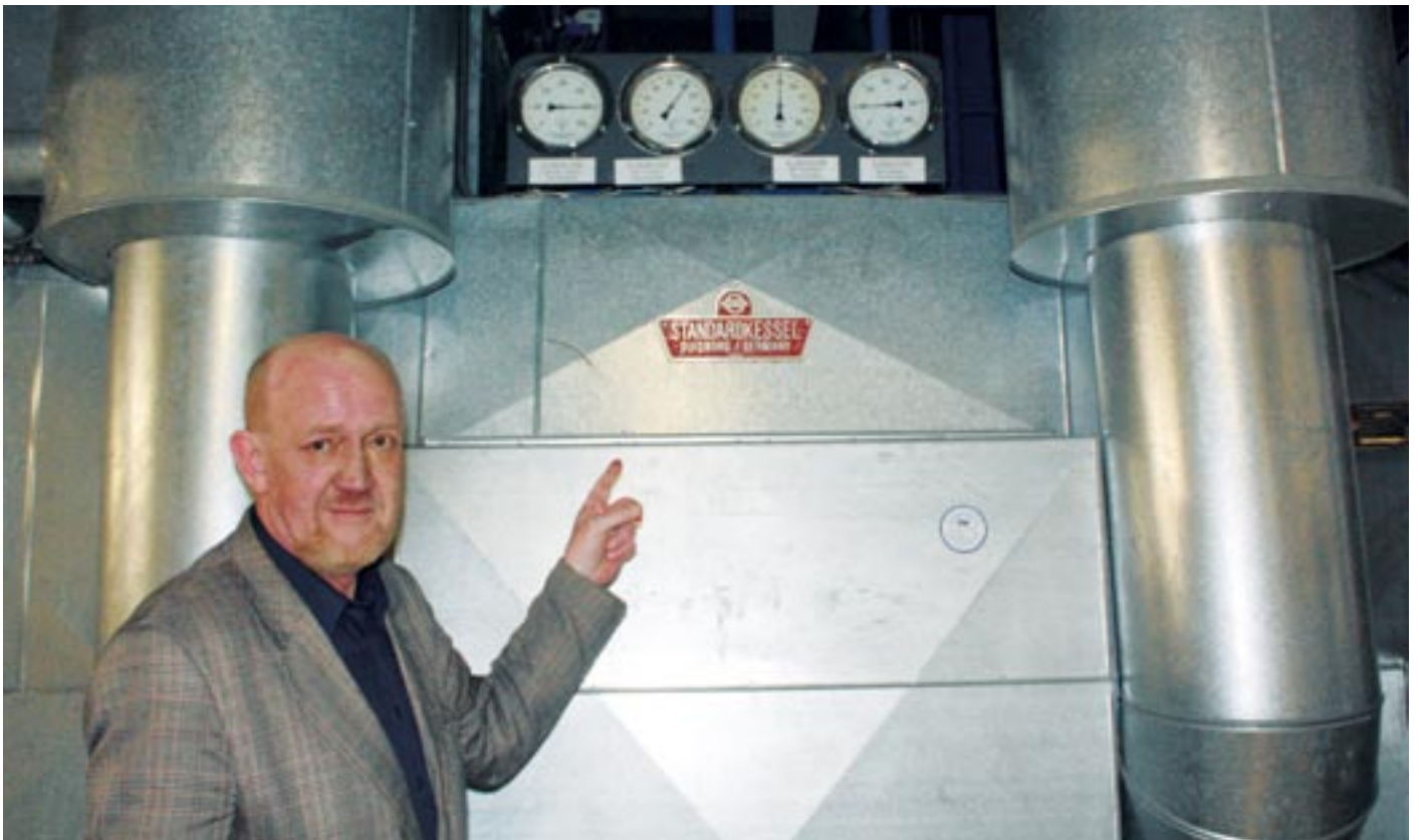
EVB-Mitarbeiter Rüdiger Werner ermöglicht einen Blick auf den Abhitzeessel des Gasturbinen-Heizkraftwerks.
